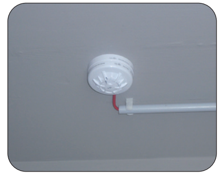
Wärmemelder zur Ansteuerung der Türfeststellanlage
