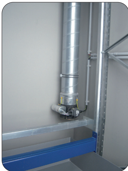
Ex-Abluftanlage inkl. brandgeschützter Lüftungselemente
